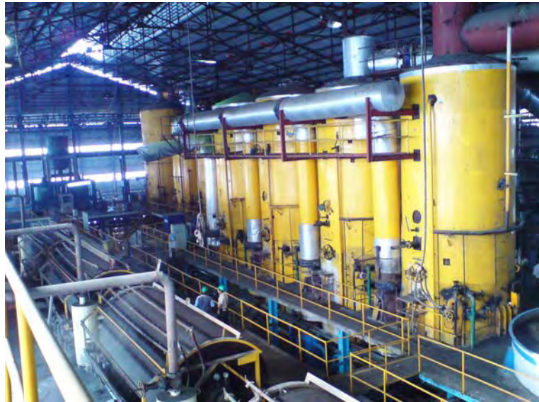
En la planta se está controlando 6 calderas para la generación de vapor.
